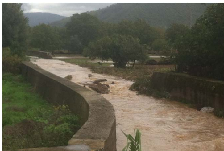
Crollo degli argini del Torrente Solofrana (Foto del 15.10.2015).
